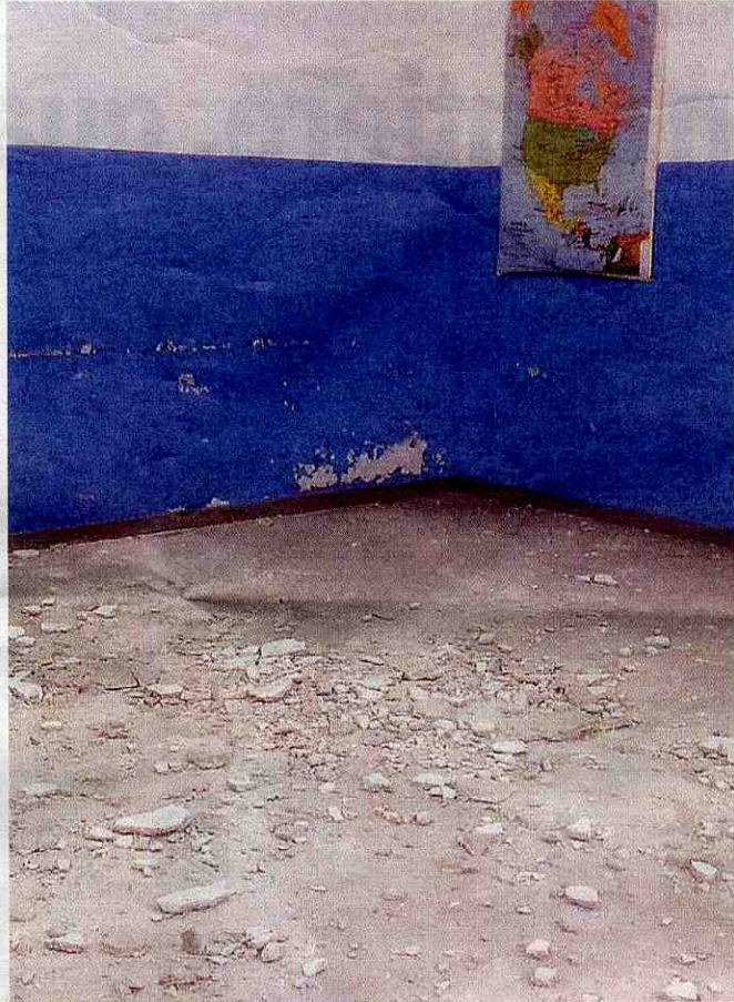
Il pericolo. I calcinacci caduti di recente all'interno di due aule
